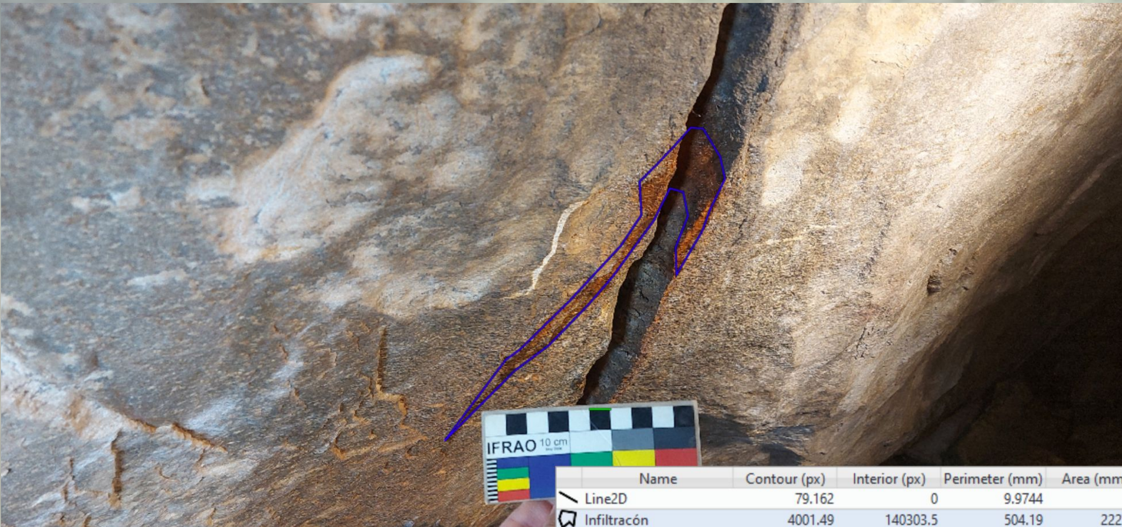
Fig 4. Infiltración de agua
